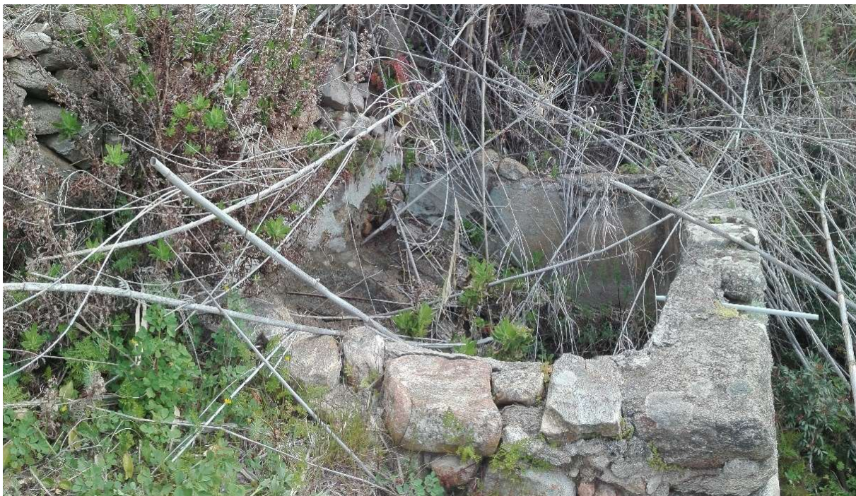
Figura 5 – Esempio di vasca in muratura ormai non più in grado di mantenere un livello idrico adeguato.
