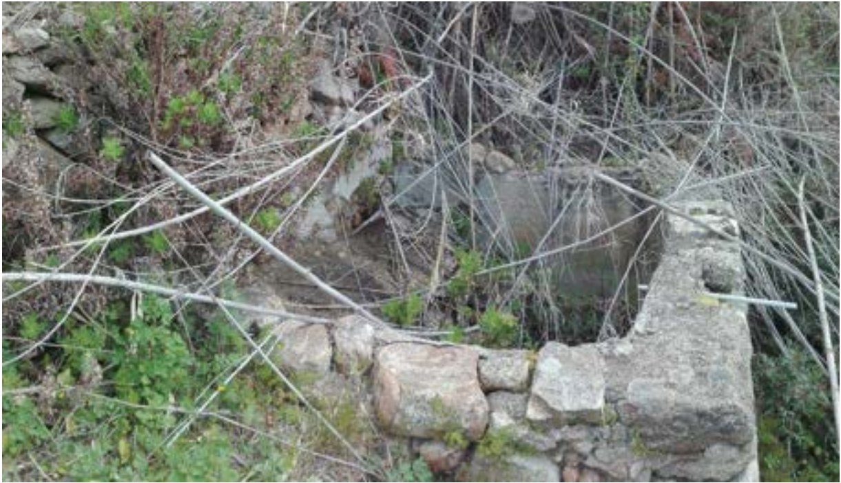
Figura 6 – Esempio di vasca in muratura ormai non più in grado di mantenere un livello idrico adeguato.
